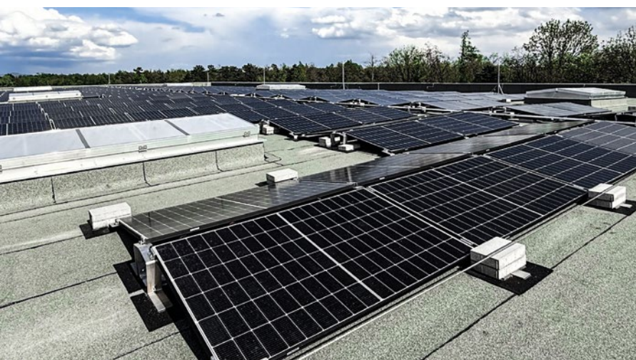
Photovoltaik-Anlage beim neuen REXEL-Standort in Linz
